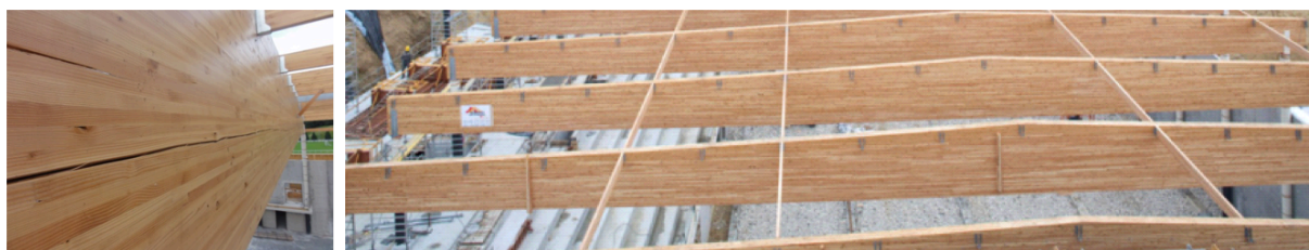
Fig. 9 : Fissuration de retrait hydrique sur charpente lamellé-collé
